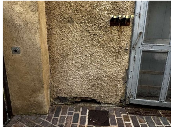
Cour intérieure — ouvertures condamnées, vitrages brisés.
