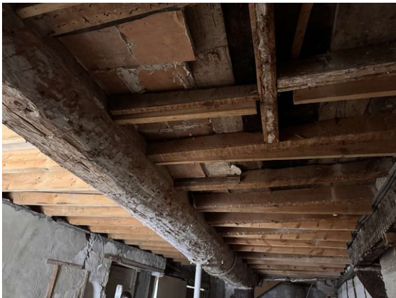
Solivage bois du plancher — la question structurelle centrale du projet.
